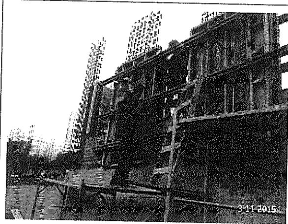
Fotografía N° 5: Personal en altura sin elementos de protección.
